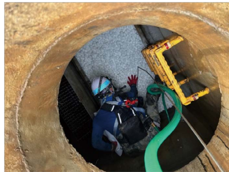
비점오염저감시설 필터 교체
