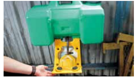
협력사 워크숍 내 간이 세안 장치 설치
